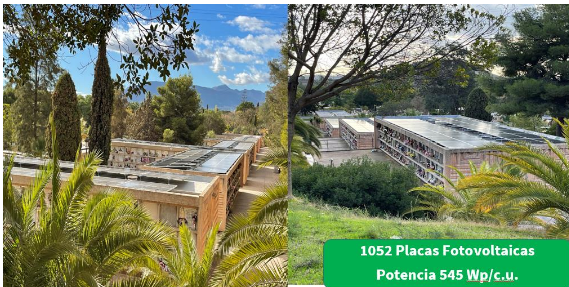
Figura 1: Imágenes de la instalación fotovoltaica ya disponible por parte de PARCEMASA
